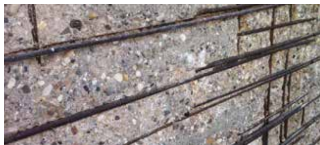
Korozija armaturnih čeličnih šipki i odvajanje betonskog pokrivača
