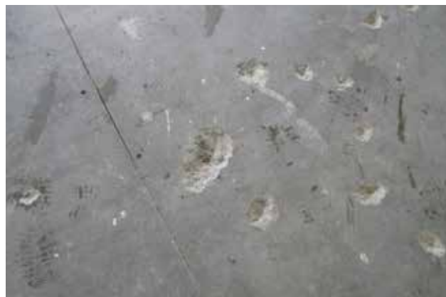
Mali dijelovi koji su iskočili na betonskoj površini.
