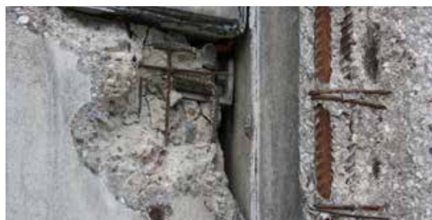
Propadanje betona u konstrukcijama koje su u dodiru s morskom vodom i izložene napadu klorida.
